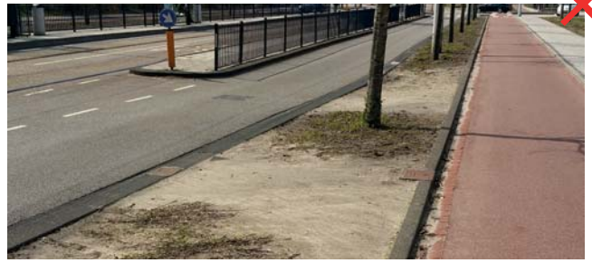
Olifanten paadjes geven schade aan de bermbeplanting.
